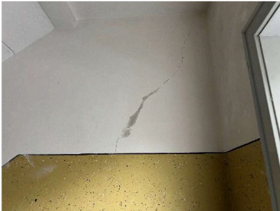
Revner i vægge i hovedtrappe
