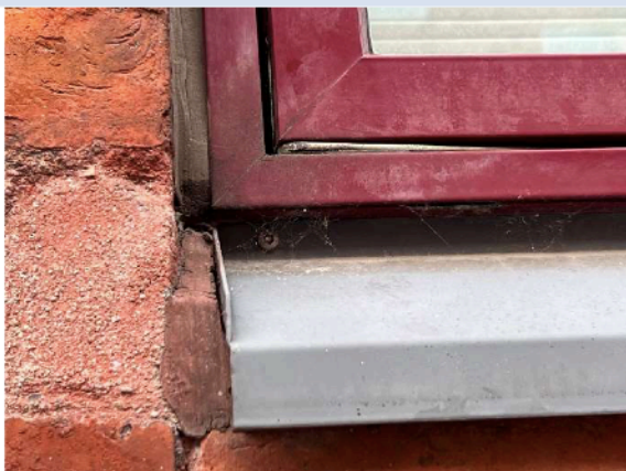
Vindue mod gaden, udtjent elastisk fuge
