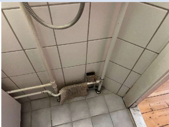
Vandrør på badeværelse
