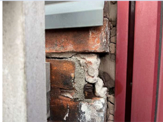
Facade mod gaden, jern fra gamle altaner forårsager skader i murværk
