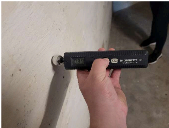
Kraftig opfugtet kældervægge
