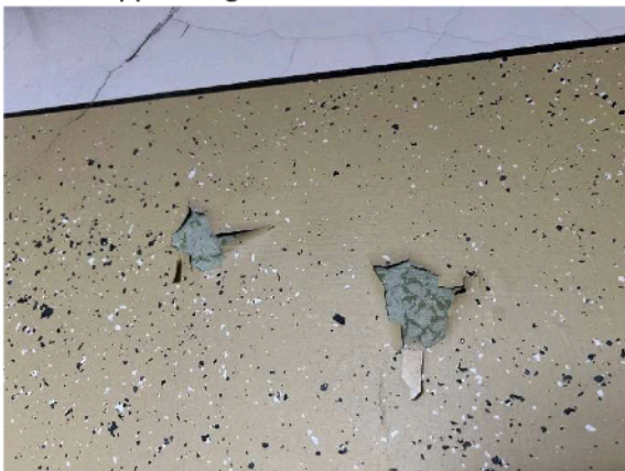
Afskalning i maling revner i vægge på hovedtrappe
