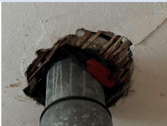
Manglende brandsikring i gennemførelse
