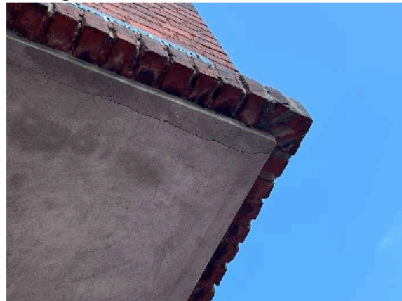
Facade mod gaden, ses revner på underside
