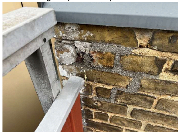
Facaden mod gården, jern fra gamle altaner forårsager skader i murværk
