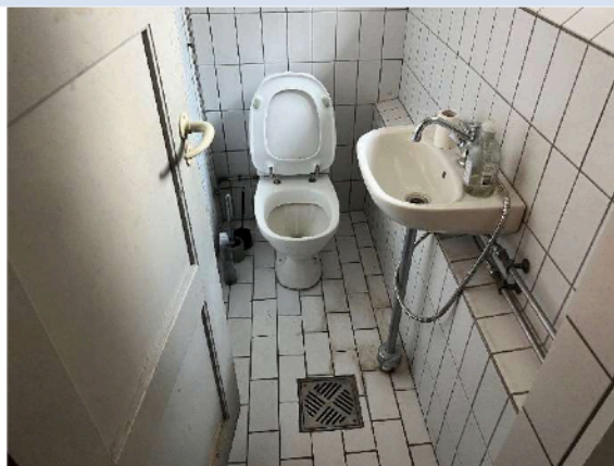
Fælles toilet i kælder
