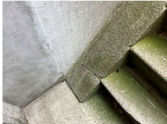
Revner og løsbeton på kældertrappe
