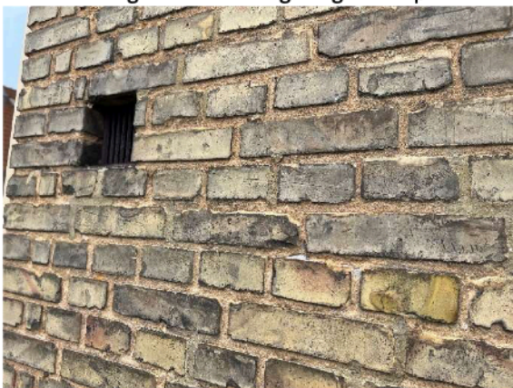
Facaden mod gården ses steder med forvitrede fuger
