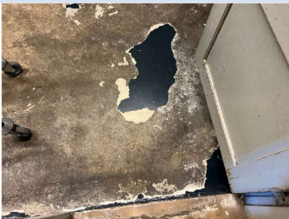
Afskallet malingslag på kældergulv
