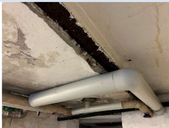
Blottet bærejern ses med korrosion
