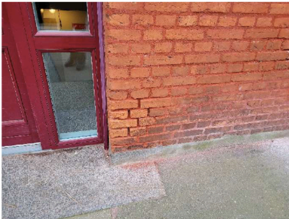
Forvitrede og udvaskede fuger og afskal på sokkel
